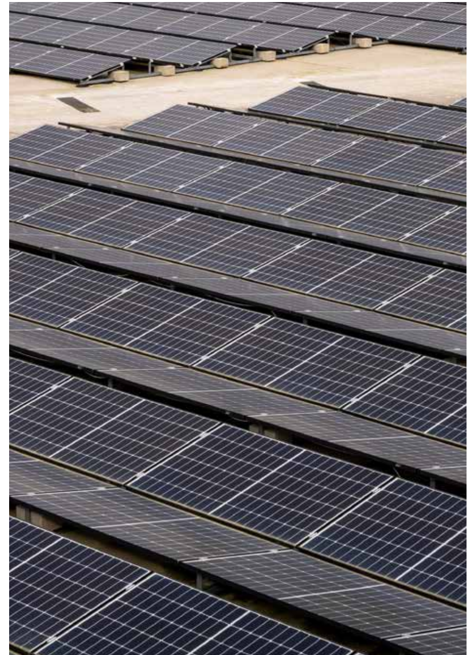
Fotovoltaïsche panelen op de Wevelgem (B) site
